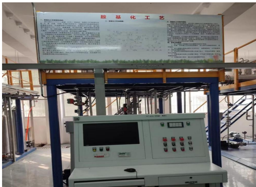
图7-9 化工实训基地特殊工艺作业设备
